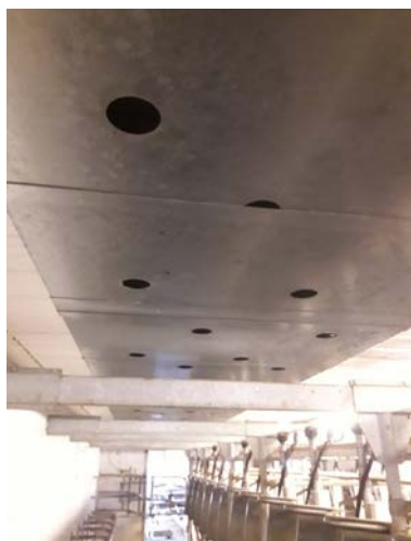
Photo 21 Ventilation via le plafond (Crédit photo : BTPL)
